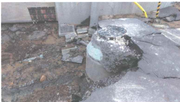
<液状化による被災状況> (札幌市清田区)
