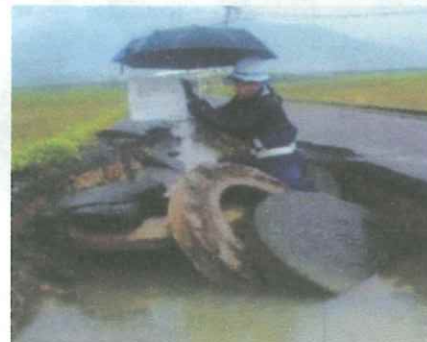
下水管理戻し部の液状化による沈下(熊本県益城町)
