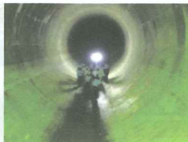
雨水貯留管(東京都)
