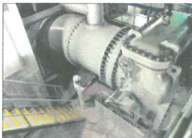
雨水ポンプ(広島市)
